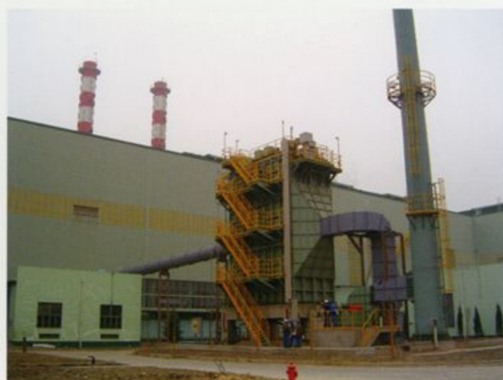
平成15年、中国・上海に納入 熱間圧延機用 1000m 3 /min 湿式電気集塵機
