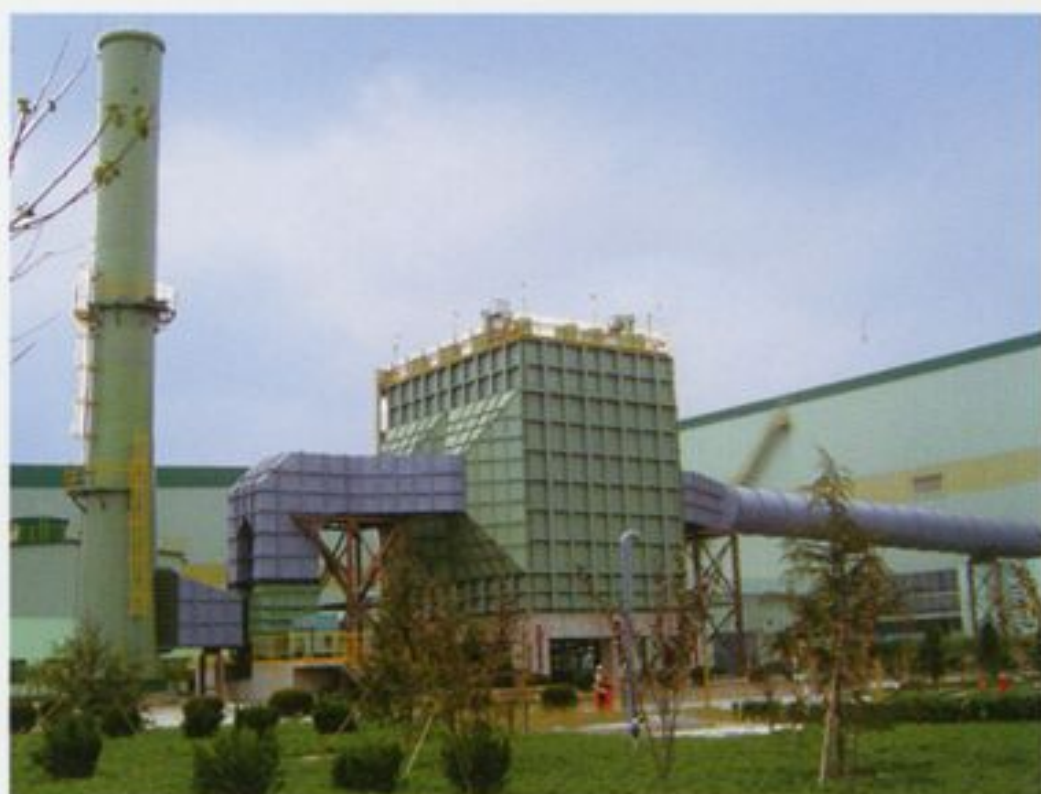
平成15年、中国・上海に納入 熱間圧延機用 6000m 3 /min 湿式電気集塵機
